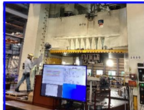
工場に設置された大型モニターで 日程や進捗状況を確認
